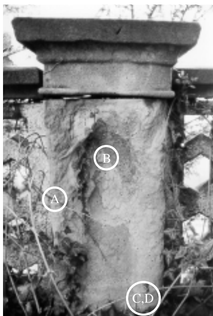
Slika 1: Korodiran kamniti stebrič, iz katerega so bili odvzeti vzorci Figure 1: Damaged stone pillar, showing sampling location
